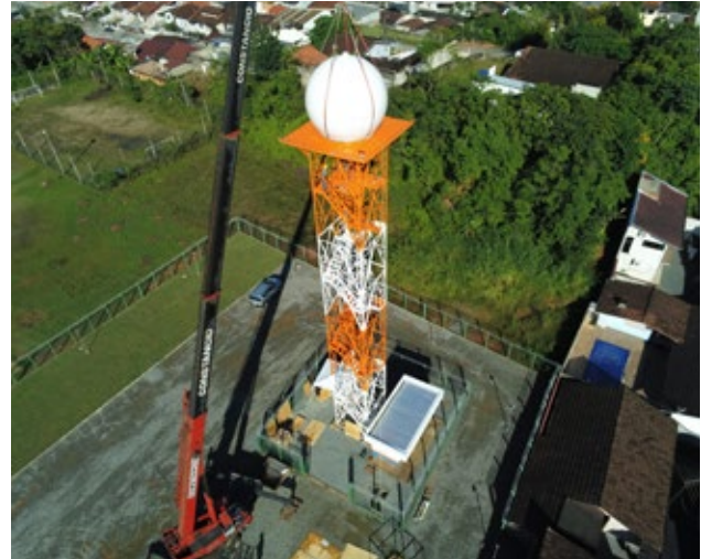
Instalação de radar meteorológico Foto: ASCOM/SDC
